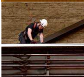
Bei Wartungs- oder Reinigungsarbeiten müssen Mitarbeiter oft nah an den Rand der Kranbahnschiene.
