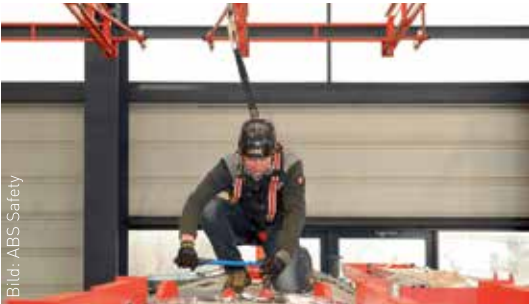
Pendelsturz ausgeschlossen: Das fahrbare Absturzsicherungssystem lässt sich genau über den Technikern positionieren.
